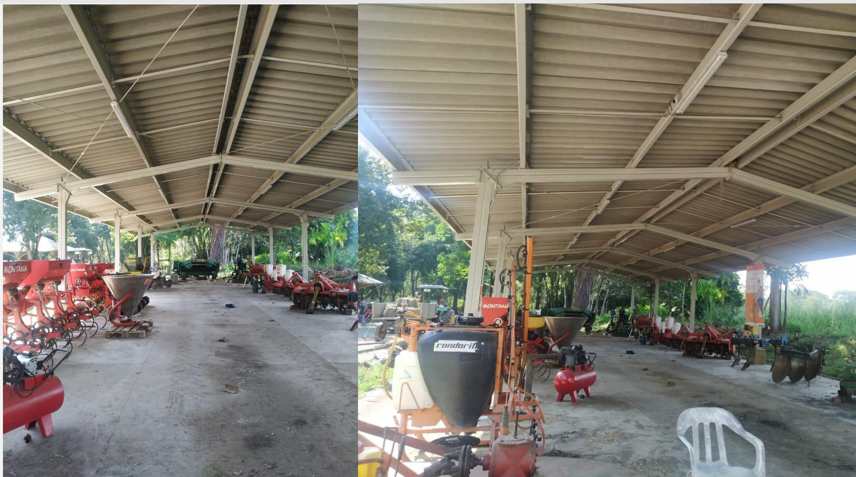
1.Instalación luminaria nuevas y salidas de potencia Bodega de Maquinaria – Centro Agrario Cotové
