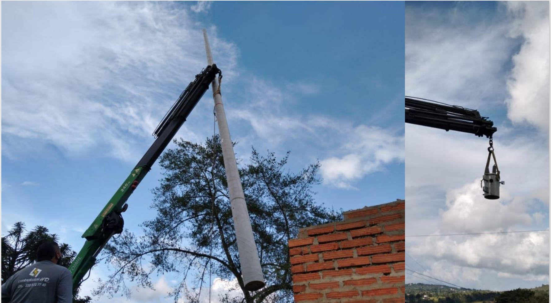
1.Instalación transformador de 25KVA- Centro Agrario Paysandú
